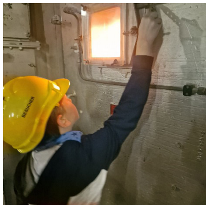
Blick in den Verbrennungsofen
